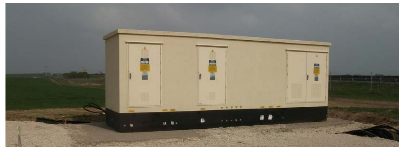
Photographie 69. Poste de livraison des Breuils Source : ABO-Wind
